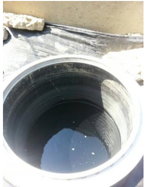
過高的地下水位
